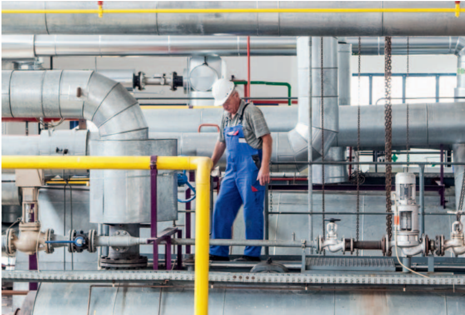
Bringfried Berger ist wie sein Kollege René Weinert ausgebildeter Kesselwärter. Beide kennen die EVR-Anlage in Rochlitz aus dem Effeff.
